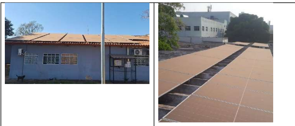
Figura 66: instalação da Usina Fotovoltaica - eficiência energética
